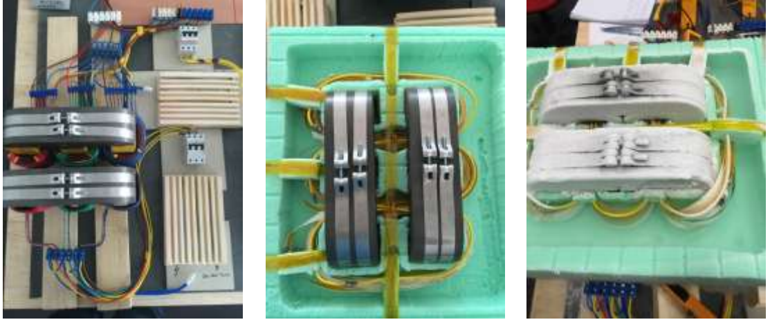
Şekil 3.7 3-fazlı 6 kVA'lık sisteme ait görseller
