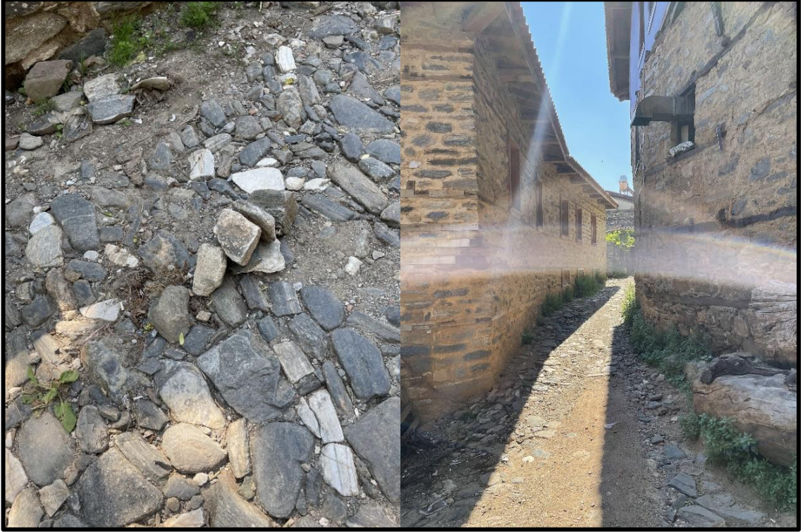
Şekil 4.59 Cumalıkızık köyünde bulunan bozulmuş döşemeler (Orijinal 2021)
