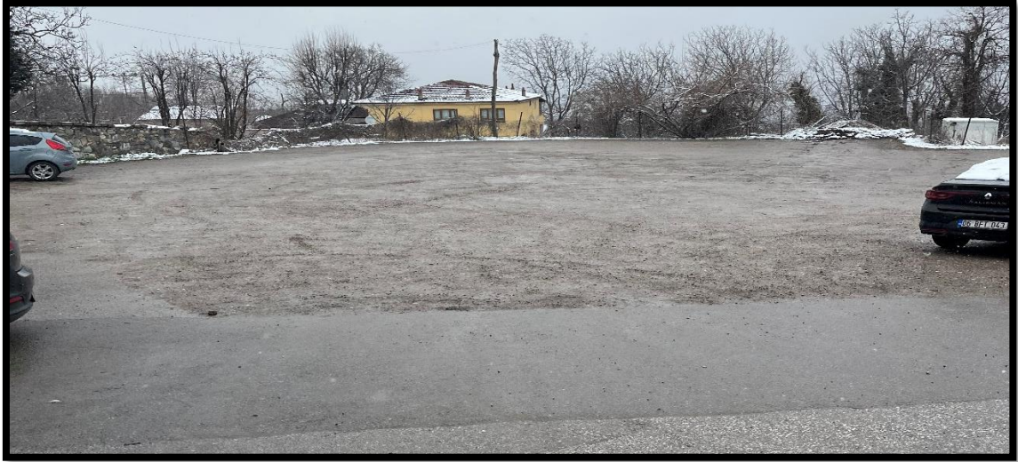
Şekil 4.48 Otopark alanında asfaltta meydana gelen bozulmalar (Orijinal 2022)
