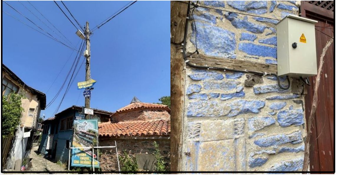
Şekil 4.57 Köyde bulunan elektrik direği ve panosu (Orijinal 2021)
