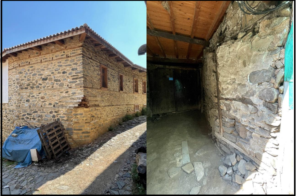
Şekil 4.44 Şekil bozulmuş ve eksilmiş döşemeler (Orijinal 2021)
