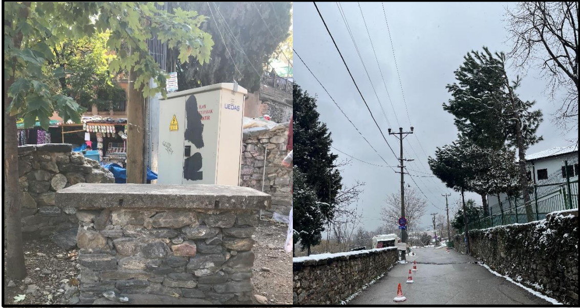
Şekil 4.47 Elektrik panosu ve kabloları (Orijinal 2021-2022)
