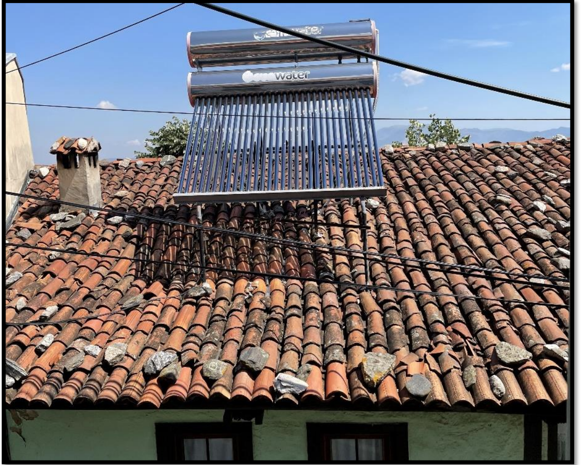
Şekil 5.1 Köyde bulunan yapıda su ısıtması için kullanılan güneş enerjisi sistemi (Orijinal 2021)
