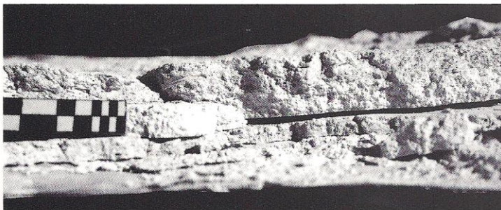
Fig. 135 : Double couche de peinture murale, pièce P26 (C13), mur ouest (C. Ç.).
