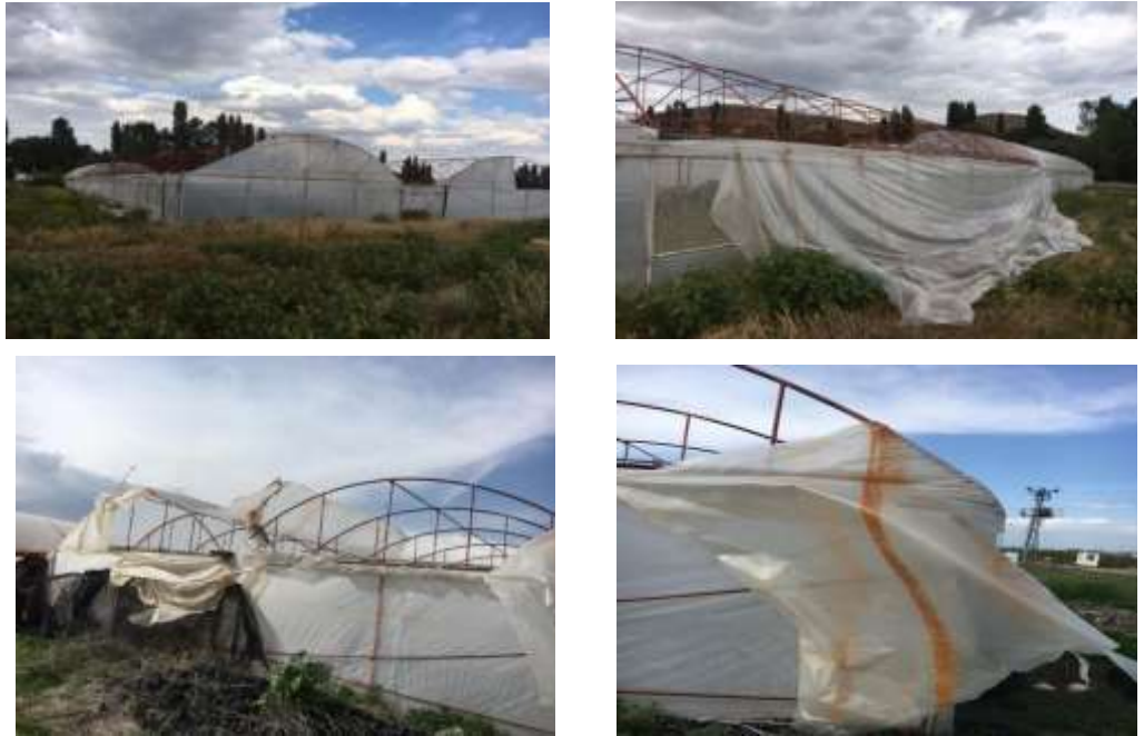
Şekil 4.6 Sera örtü malzemesi rüzgâr deformasyonu (Yenice ilçesi 5 nolu sera)
