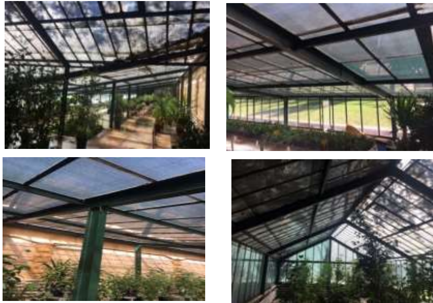
Şekil 4.4 Beşik çatılı cam sera (Yenimahalle ilçesi 7 nolu sera)
