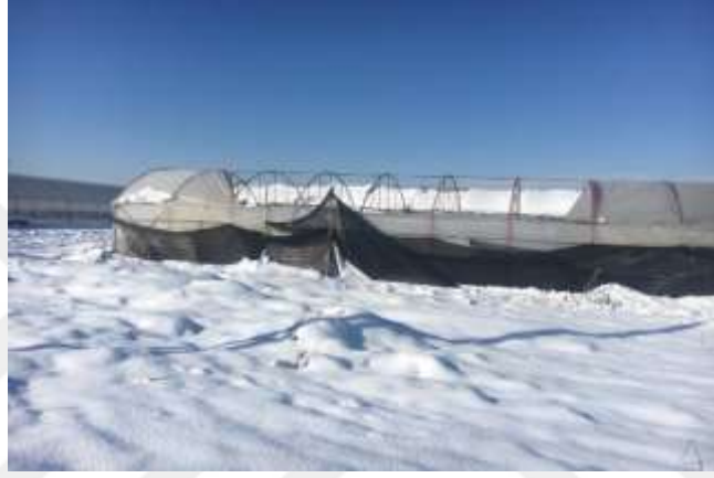
Şekil 4.9 Kar yükü yıkılması (Çubuk ilçesi 1 nolu sera)
