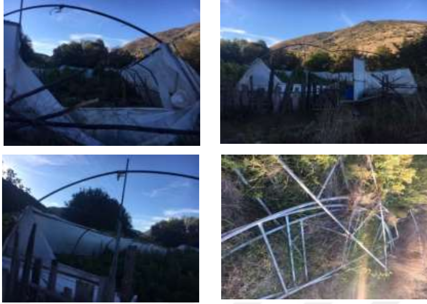
Şekil 4.5 Sera kar yükü yıkılması (Kızılcacahamam ilçesi 2 nolu sera)
