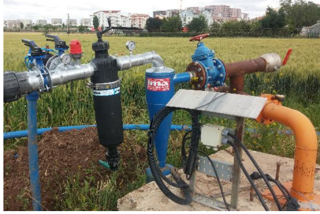
Şekil 3.5 Kontrol ünitesi ve sulama kuyusu
